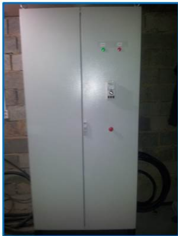
Внешний вид шкафа управления
